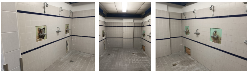
Die Duschen auf dem Polizeigelände in Schulzendorf (Dir 1) sind seit einem Rohrbruch 2023 gesperrt. Die Mitglieder der 2.TEE hüpfen bei Minusgraden über den Hof zu einem Duschcontainer.
